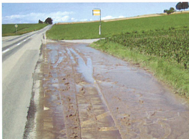
Durch Erosion verschmutzte Postautohaltestelle.
